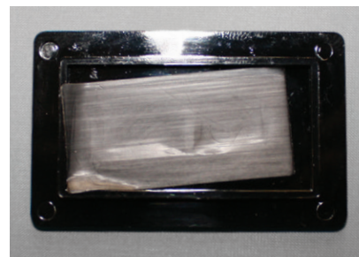
位置ずれで表面が損傷したベント
