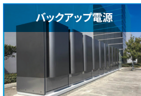
陳腐化しない、信頼性が高くクリーンなエネルギー貯蔵設備
